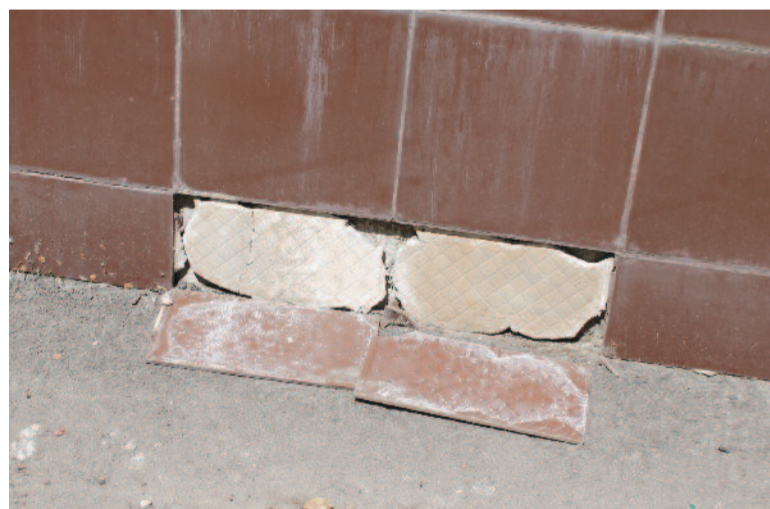
Плитка на цоколе уложена не по технологии, при простукивании выявлены пустоты, межплиточные швы требуют обновления, затирка должна быть для уличных работ
