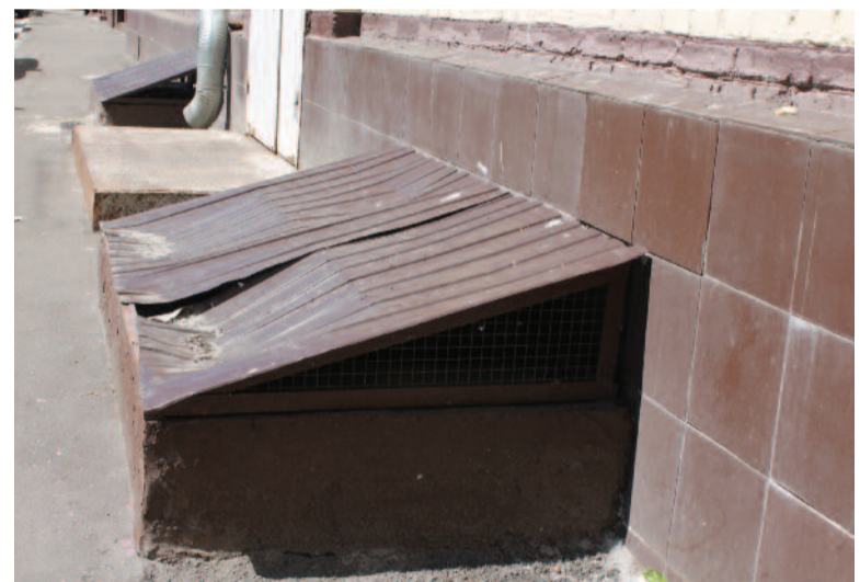
Козырьки прямиков не соответствуют ПСД, они из тонкого металла, деформированы, частично отсутствуют
