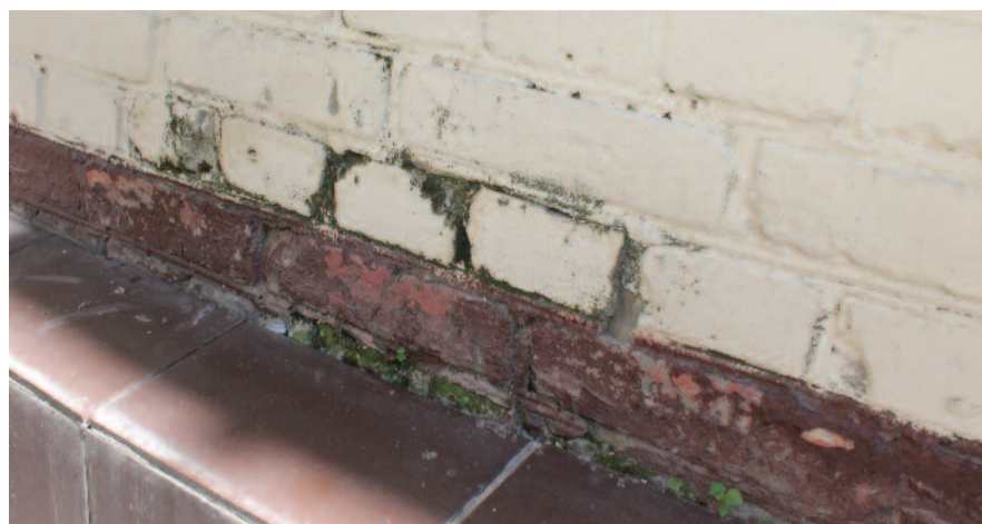
В местах намокания на фасаде проступила плесень
