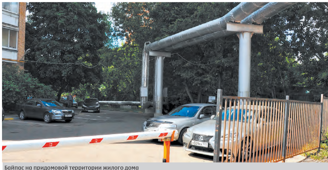
Байпас на придомовой территории жилого дома
